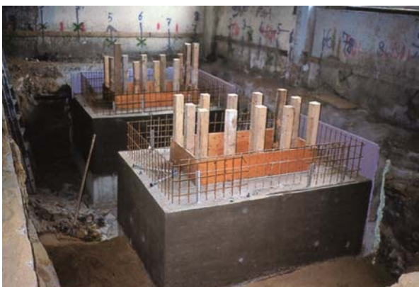
Zwei der schwingungsentkoppelten Fundamente für Rastersonodenmessapparaturen.
