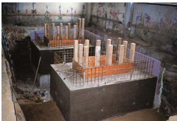
Zwei der schwingungsentkoppelten Fundamente für Rastersonodenmessapparaturen.
